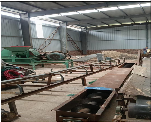
破碎机未安装（2025.10.22 拍摄）
