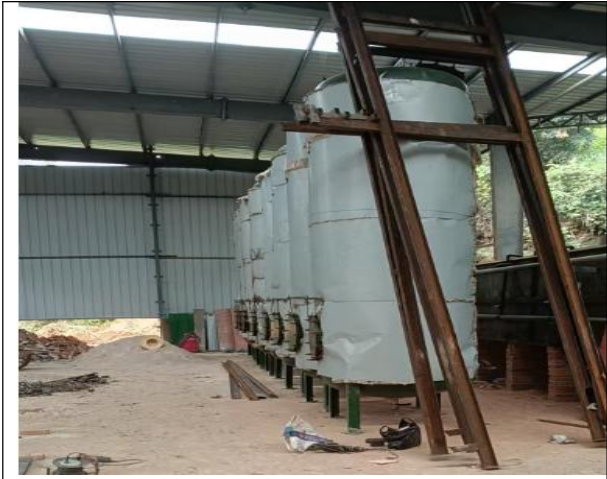
已安装 8 个蒸馏罐（2025.10.22 拍摄）
