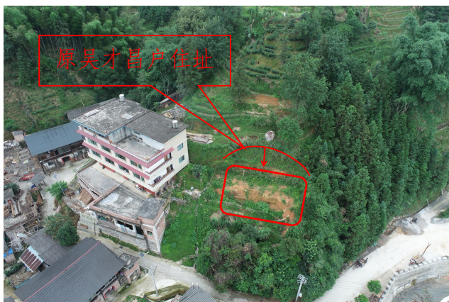
照片 3-11 三江县老堡东竹村界脚屯（吴才昌）屋后崩塌现状全景图
