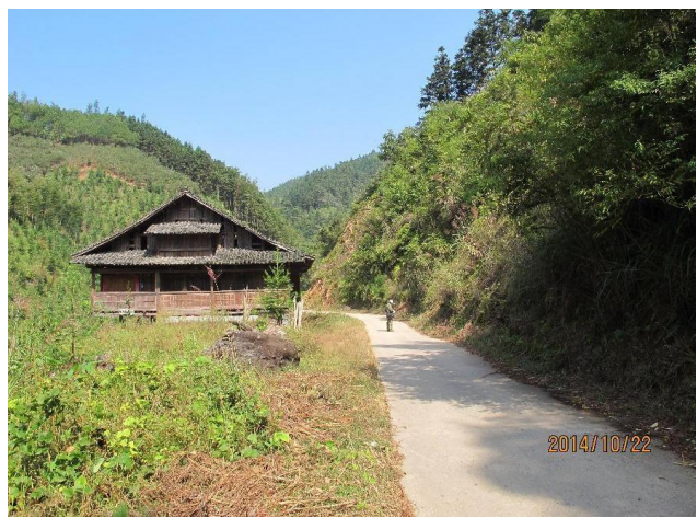
照片 3-36 三江县高基乡冲干村东山屯覃文才屋后（公路边）崩塌现状图 2
