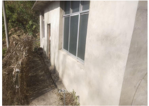
照片 3-14 美俗村分散安置点崩塌现状图 2
