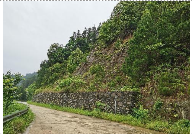
照片 3-44 吉昌屯崩塌 3 现状图
