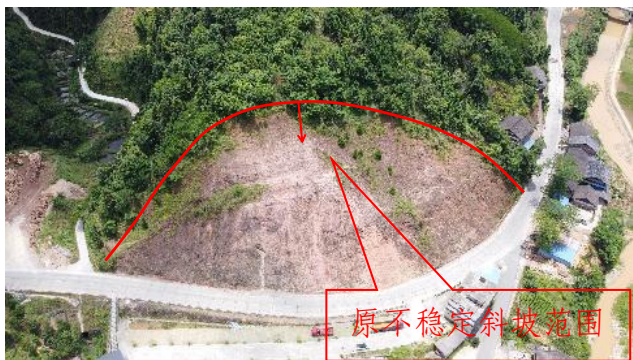
照片 3-45 原冠小屯东南侧 S506 不稳定斜坡全景图
