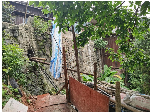
照片 3-60 独峒镇知了村知了屯（杨涓屋后）不稳定斜坡现状图
