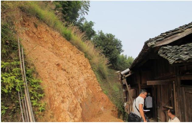
照片 3-9 原古宜镇古皂村三冲屯（郭金秀） 崩塌现状图
