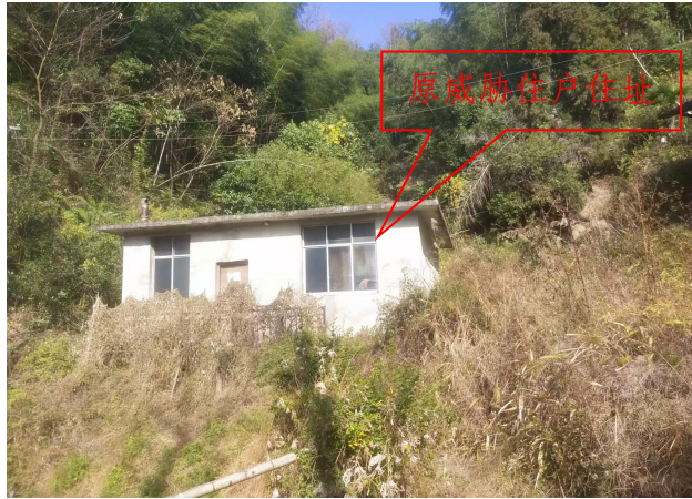
照片 3-13 美俗村分散安置点崩塌现状图 1
