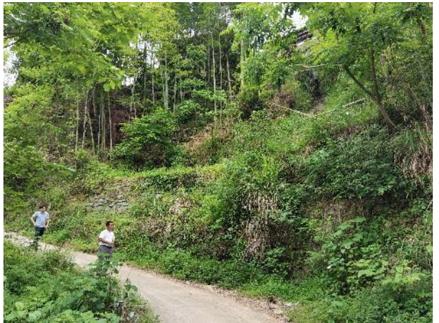
照片 3-62 独峒镇知了村归滚屯（杨通芳屋前）不稳定斜坡现状图
