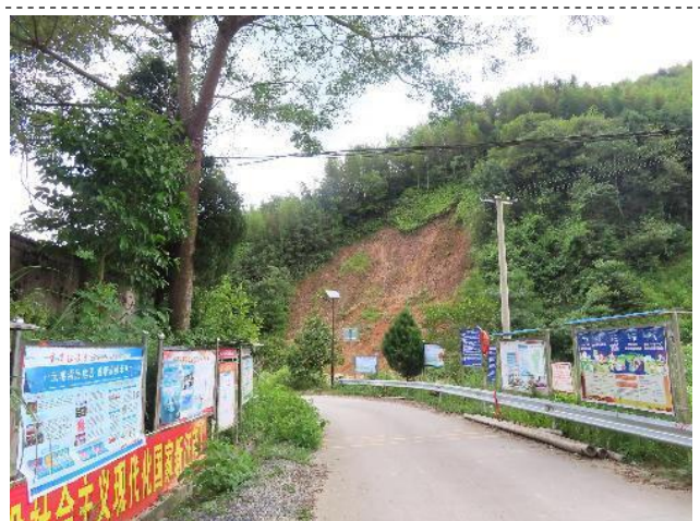
照片 3-20 拉旦屯滑坡现状图
