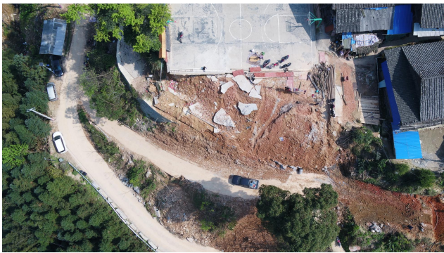
照片 3-23 原白文屯崩塌全景图
