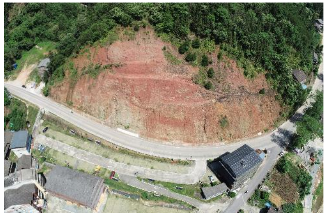
照片 3-46 冠小屯东南侧 S506 不稳定斜坡现状全景图
