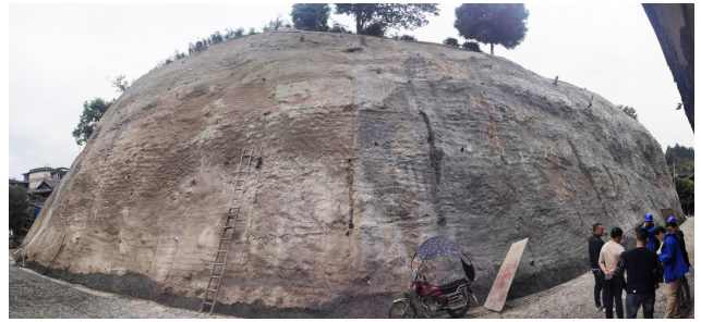
照片 3-22 和平屯不稳定斜坡现状图
