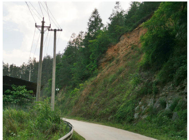
照片 3-42 八已屯不稳定斜坡现状图
